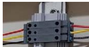
شکل ۱۰: ترمینال فیوزخور جهت حفاظت چراغ های سیگنال
