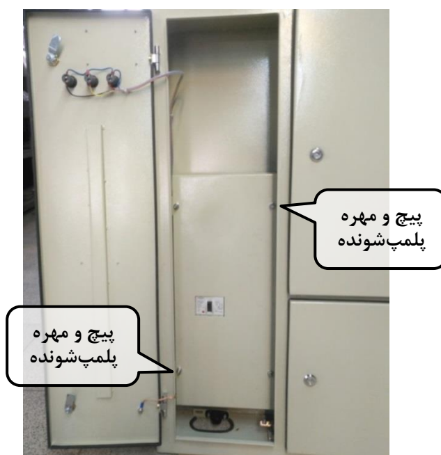
شکل ۲: روبند قسمت ورودی
